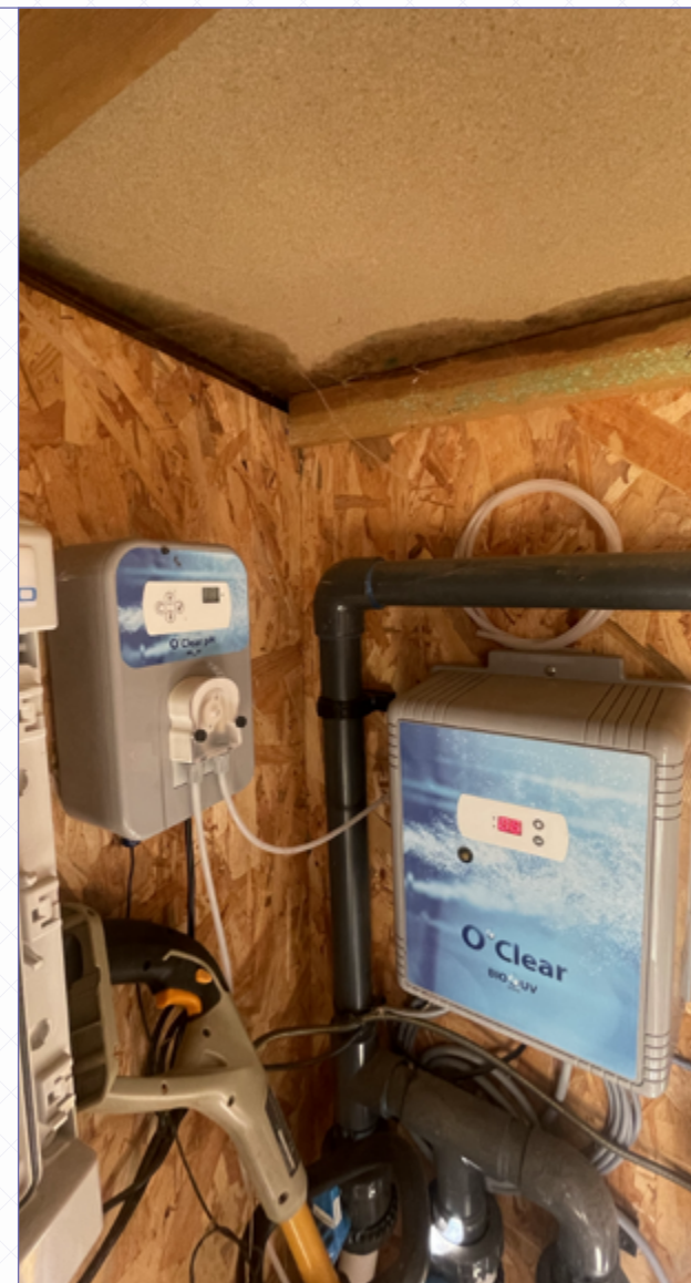
Système UV de filtration de la piscine
