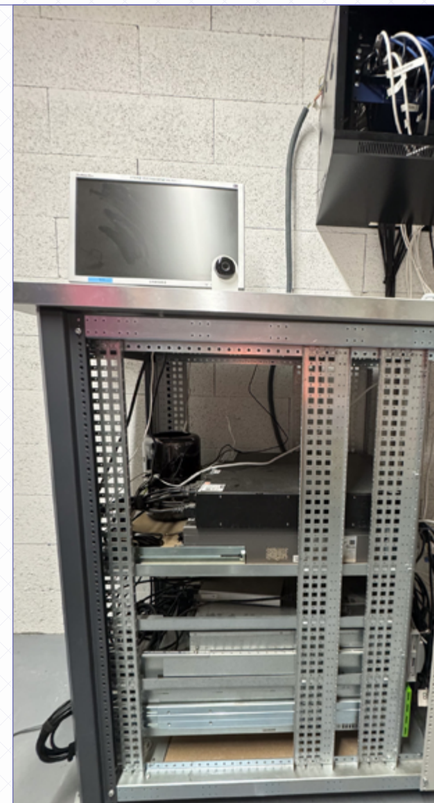
Salle serveur free-cooling (cave rafraîchie naturellement)
